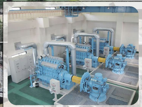
更新された洪水用排水ポンプ (縦軸斜流φ1650mm(6.32m/s)×3台)
